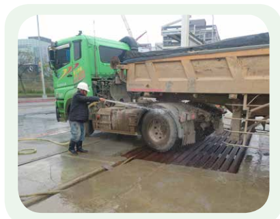
洗車台 車輛清洗與沉澱過濾
