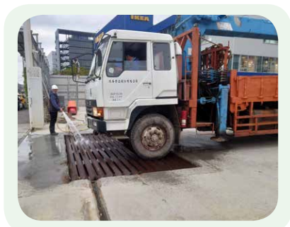
洗車台 車輛清洗與沉澱過濾
