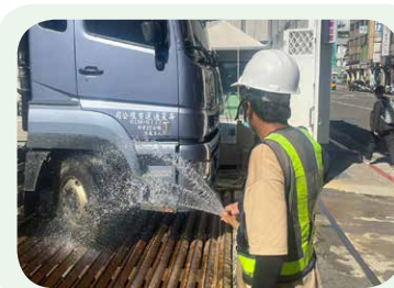
洗車台 車輛清洗與沉澱過濾
